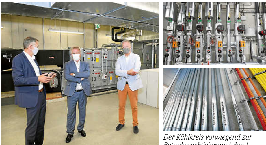
Blick in die Energiezentrale der Stadtwerke. Im Hintergrund die Lüftungsanlage mit Wärmerückgewinnung über ein modernes Wärmerad.
