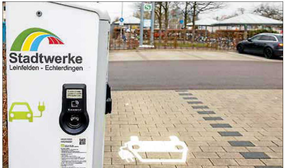
Gut ausgelastet: die Ladesäule an der Bahnhofstraße in Leinfelden.
