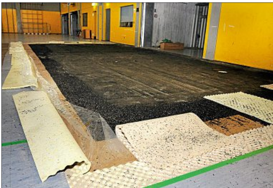
Die Feuchtigkeit hat dem Hallenboden zugesetzt. Der schwarze Belag ist allerdings nicht Schimmel, sondern die Ausgleichsschüttung.
